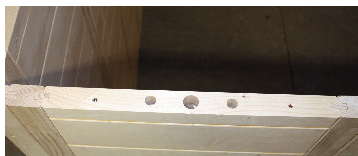
Élément électrique à gauche - sortie d'air derrière à droite.
